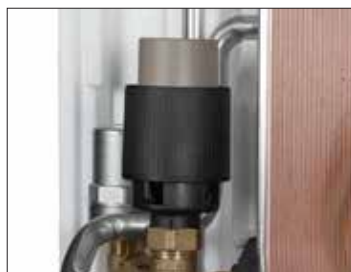
Reguleringsventil til brugsvandstemperatur.
